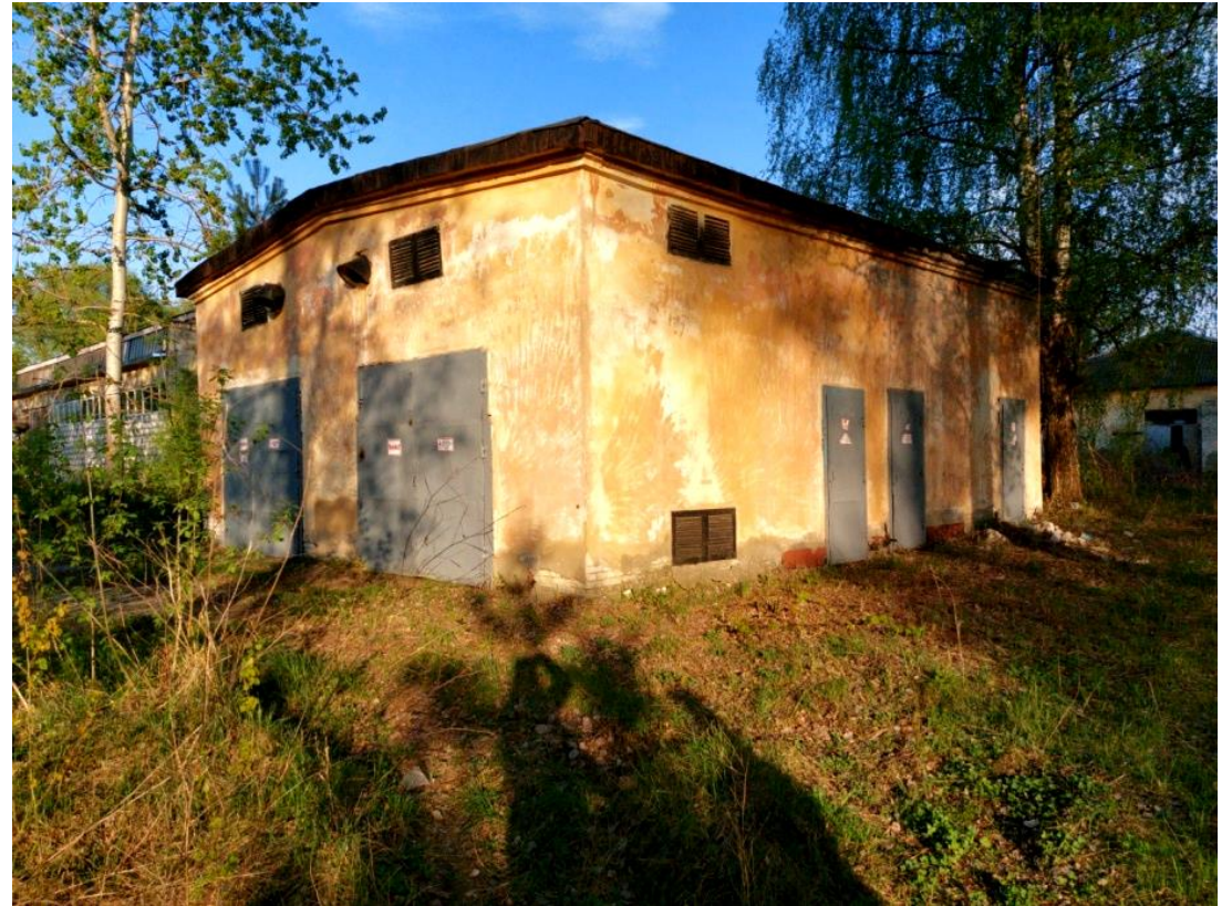
Трансформаторная подстанция (современное строение).
